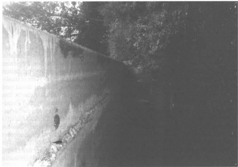
Obr. 2. Spodní strana betonového mostu přes Ploučnici u Srstého potoka s umístěním hnízd hnizdotvorky pospolné (Atherix ibix). (Foto: Oldřich Roztočil.)
