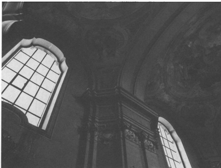
Obr. 4. Píř a úsek valené klenby, pohled z kostelní lodi (z pole u kruchty), foto autor, 6. 8. 2007.
