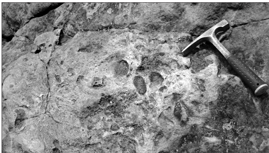
Obr. 10. Okatá textura uvnitř brekciované a silicifikované zóny v jižní stěně věže Čihadlo. „Oka“ jsou dutiny vytvořené alkalickou korozí pískovce, zčásti vyplněné novotvořenou křemitou hmotou. Foto J. Adamovič.
