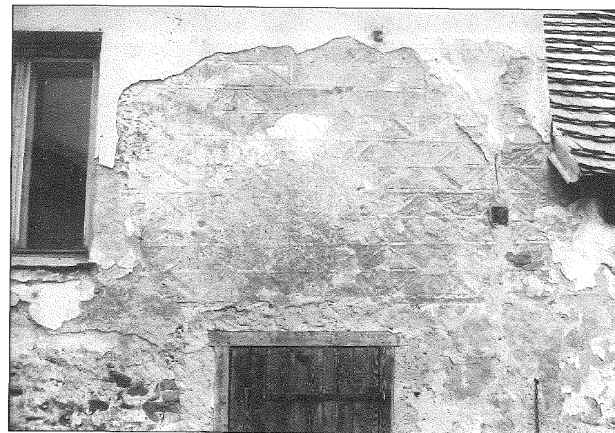
Obr. 7: Dub (Tábor), zbytky sgrafitové omítky nad vstupem do sklepa. Stav 8. července 2000, foto autor.
