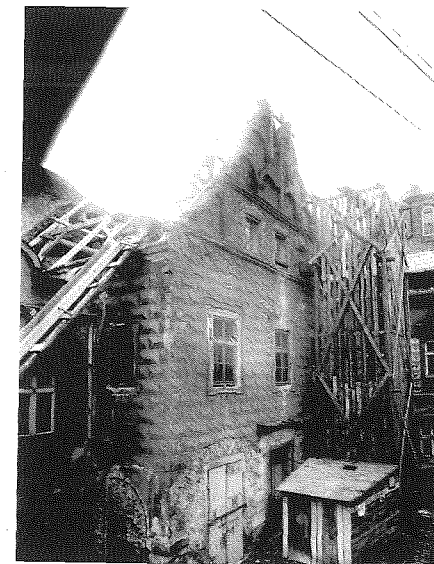
Obr. 2: Bourací práce v rámci rekonstrukce čp. 155. (SOKA Tábor, Inženýrská organizace města Tábor. Foto F. Stöber)
