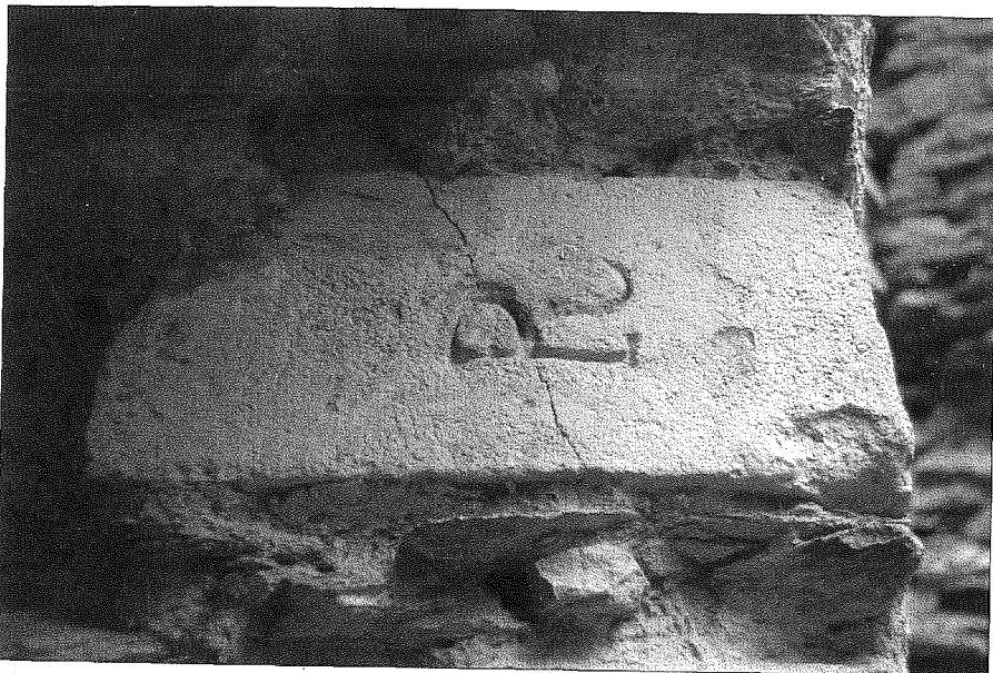
11. Radvanov – detail cihly se značkou cihelny v destruovaném záklenku v přízemí větrného mlýna. Snímek autor, červen 2010.
